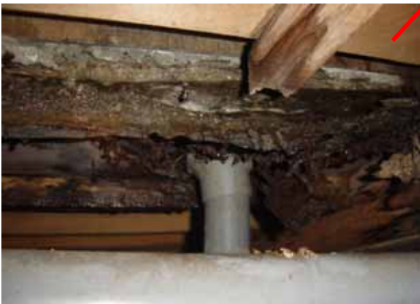
矢印の箇所の中の状態です。 中の木材部分が湿気で腐っています。
